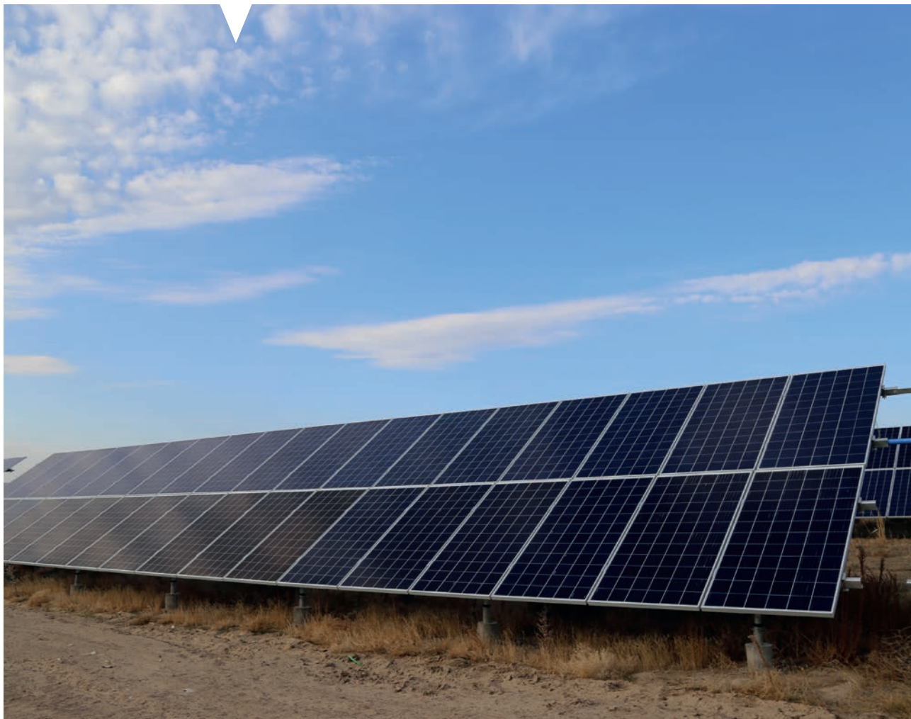
солнечные панели на СЭС в районе Капшагая Алматинской области мощностью 100 МВт
