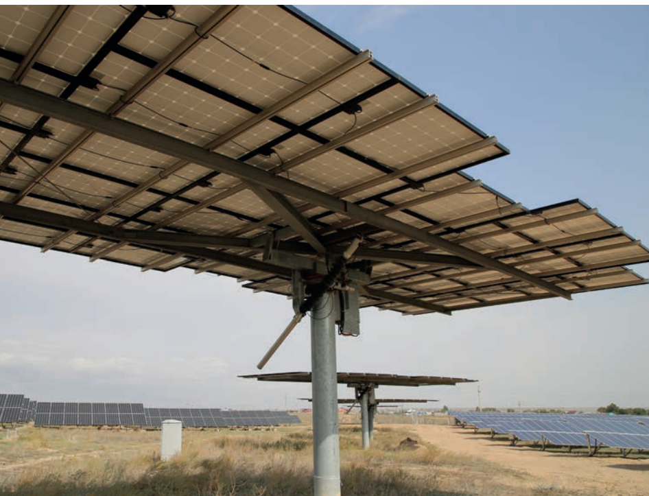
ТОО Samruk Green Energy СЗС мощностью 2 МВт
