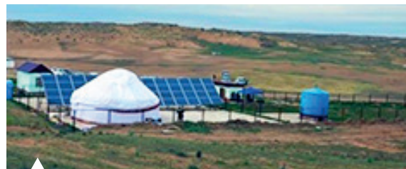
Солнечный электрогенератор, 3 кВт, Западно-Казахстанская область Источник: uralsweek.kz
