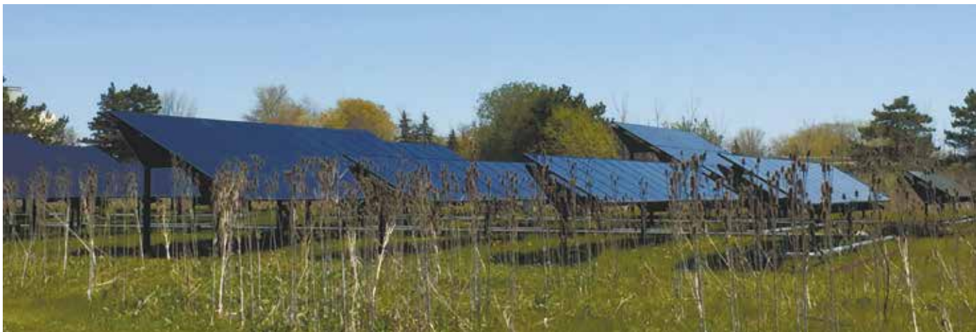
Солнечная станция Университета Баффало
