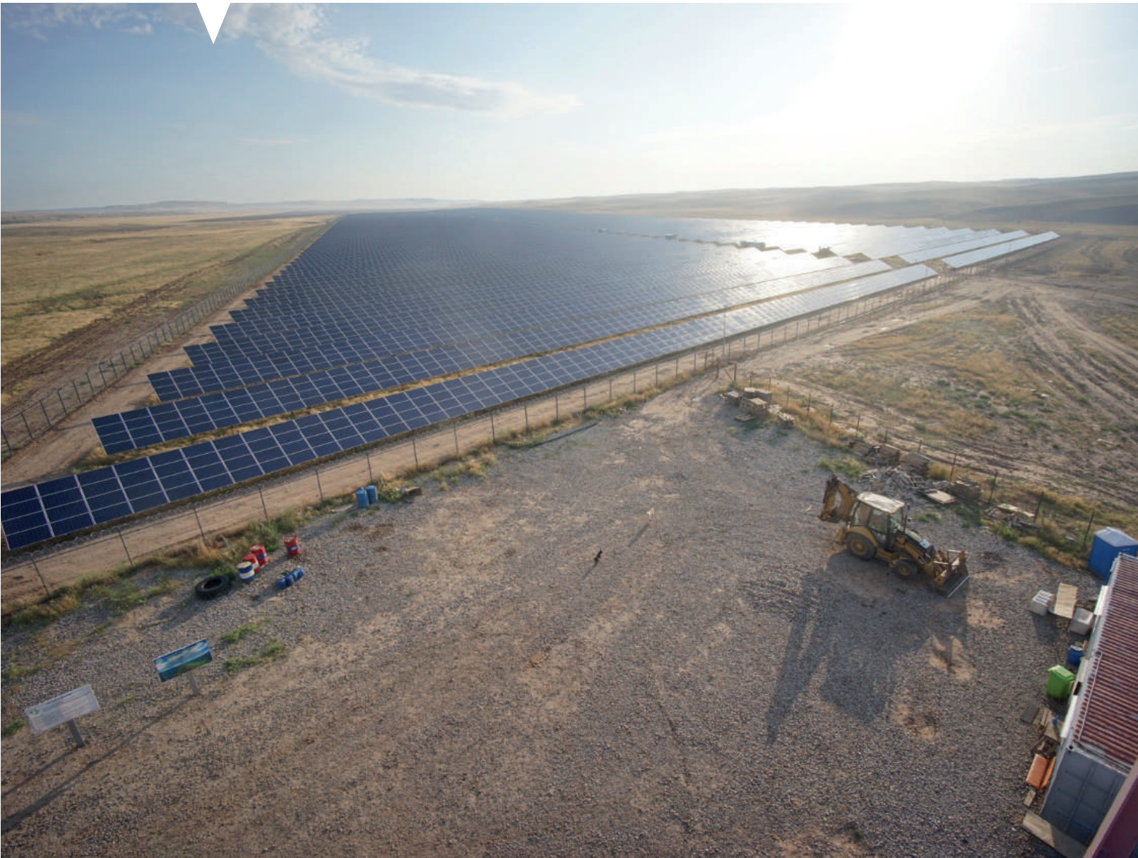
Солнечные панели на СЭС «Жылга» в Туркестанской области
