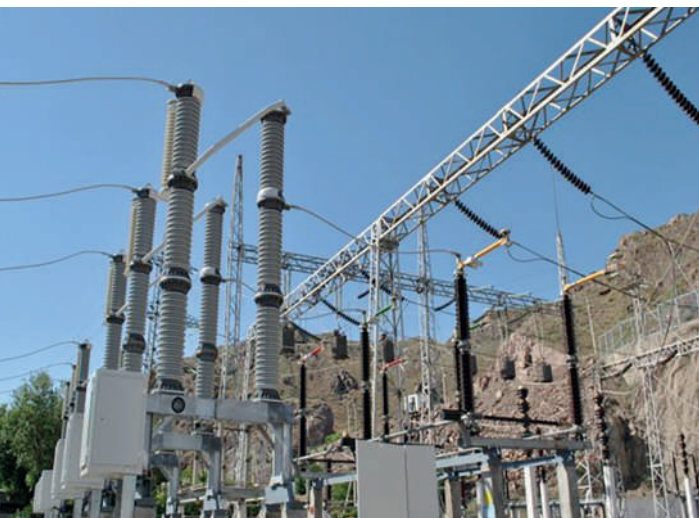
ОРУ-220 кВ. Элегазовый выключатель ВГП-220
