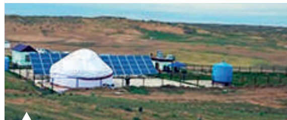
Солнечный электрогенератор, 3 кВт, Западно-Казахстанская область Источник: uralsweek.kz
